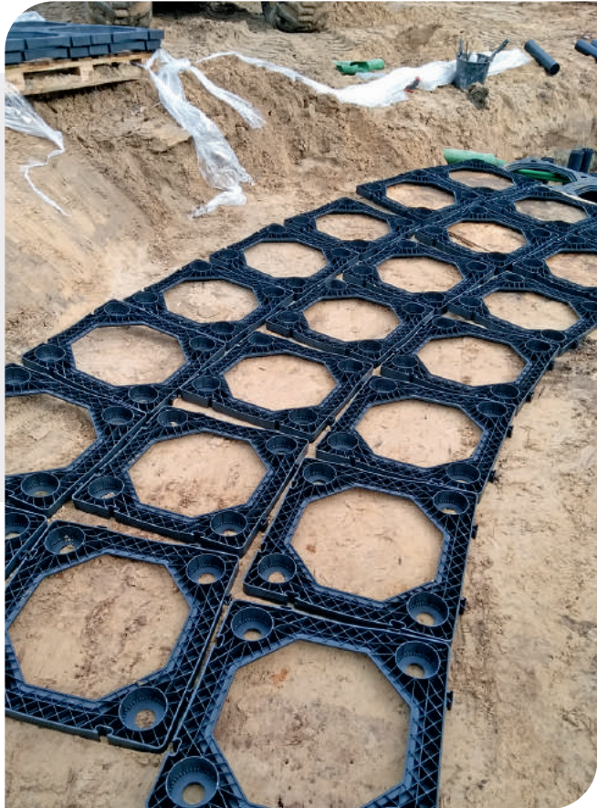
Les cadres sont alors disposés selon le schéma d'agencement. Les modules peuvent être connectés ou non (espacement maximal de 75 mm) ; l'installation peut être faite en courbe ou en quinconce. Dimension utile max. 675 x 675 mm.
