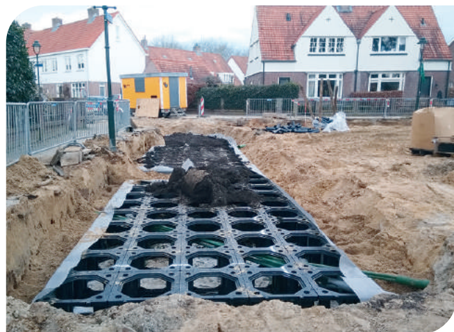
Après la pose de toutes les unités et l'intégration des câbles et des conduits, le système est entouré d'une paroi verticale. Celle-ci est perméable à l'eau et résistante aux racines.
